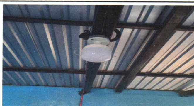
Foto 6: Sistema eléctrico instalado
