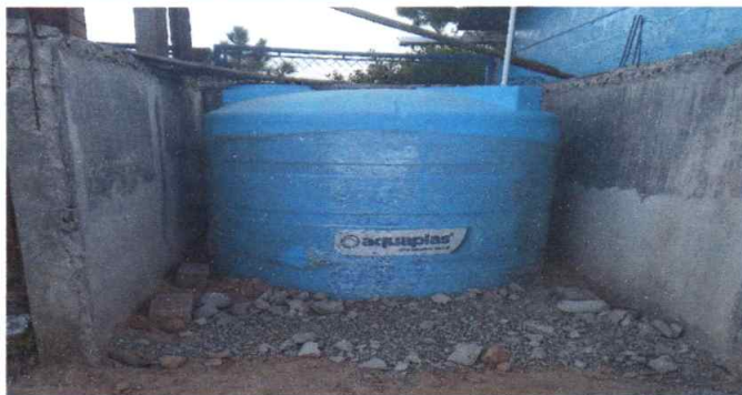
Foto 7: Cisterna de plástico instalada
